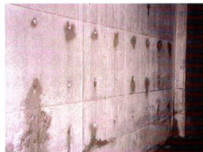
セパレータ部の漏水例
